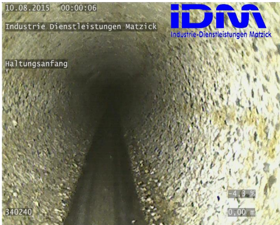
Foto: #1 Entfernung: 0,00 m Code: HA Haltungsanfang
